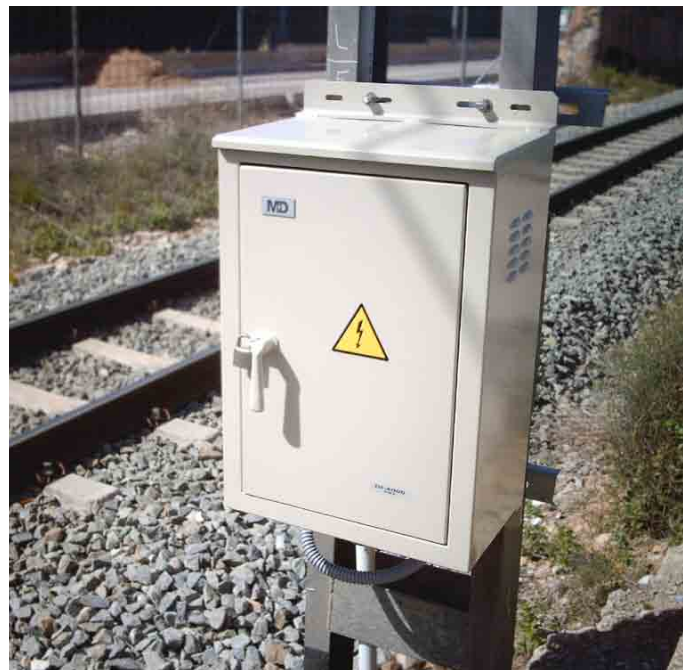
DI-4000 instalado sobre poste
